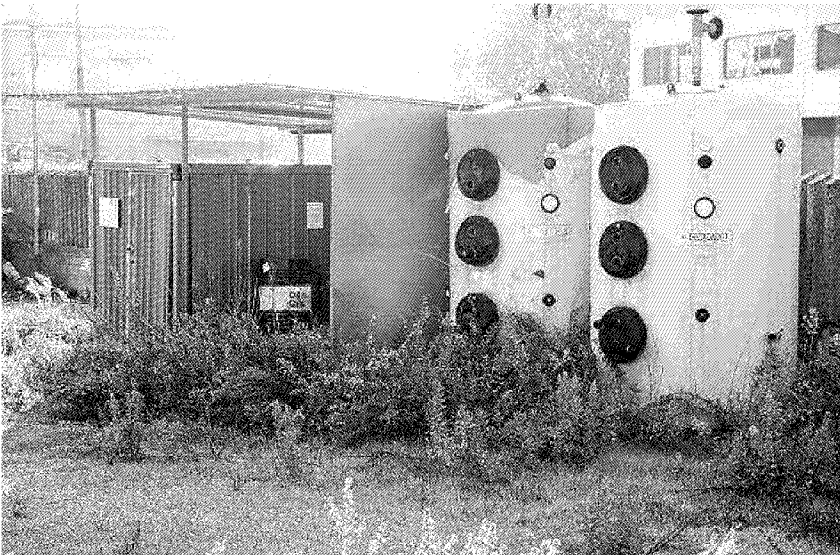
Un'altra parte dell'impianto in stato di abbandono
