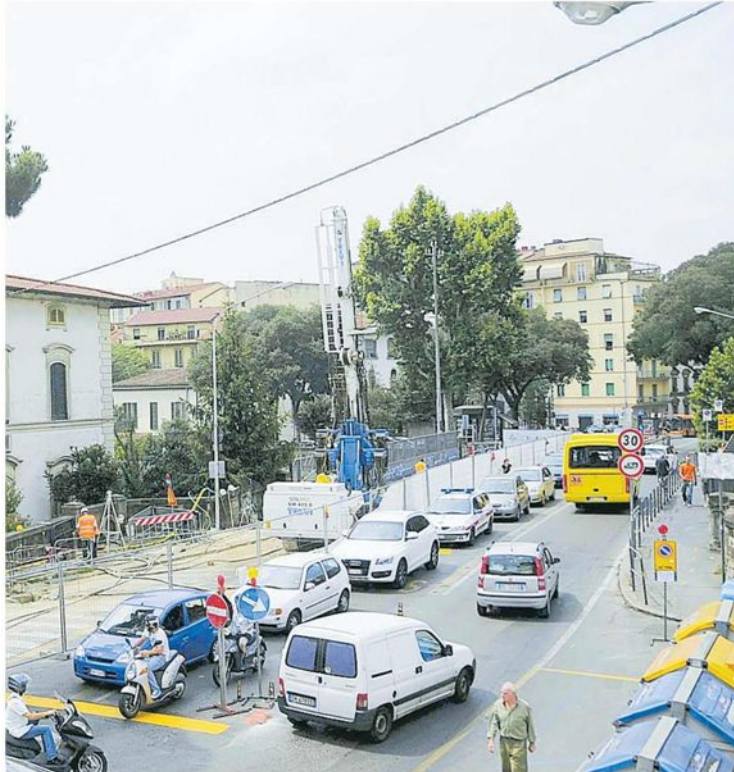
Il cantiere per il consolidamento del Ponte del Pino aperto nell'estate di sette anni fa
