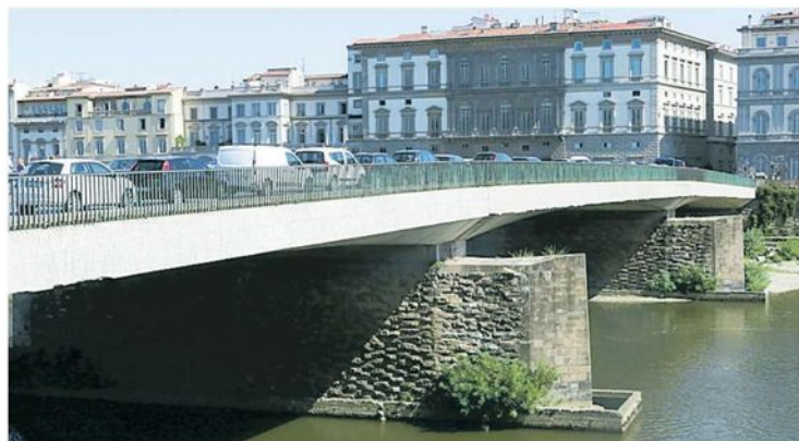
Ponte Vespucci Il pilone a rischio è il primo
