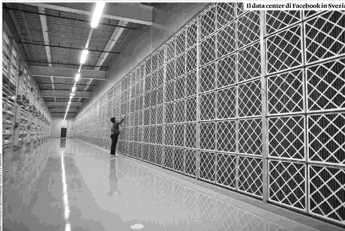
Il data center di Facebook in Svezia
