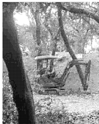
Il cantiere nella duna di San Vincenzo, sopra le demolizioni a Castagneto
