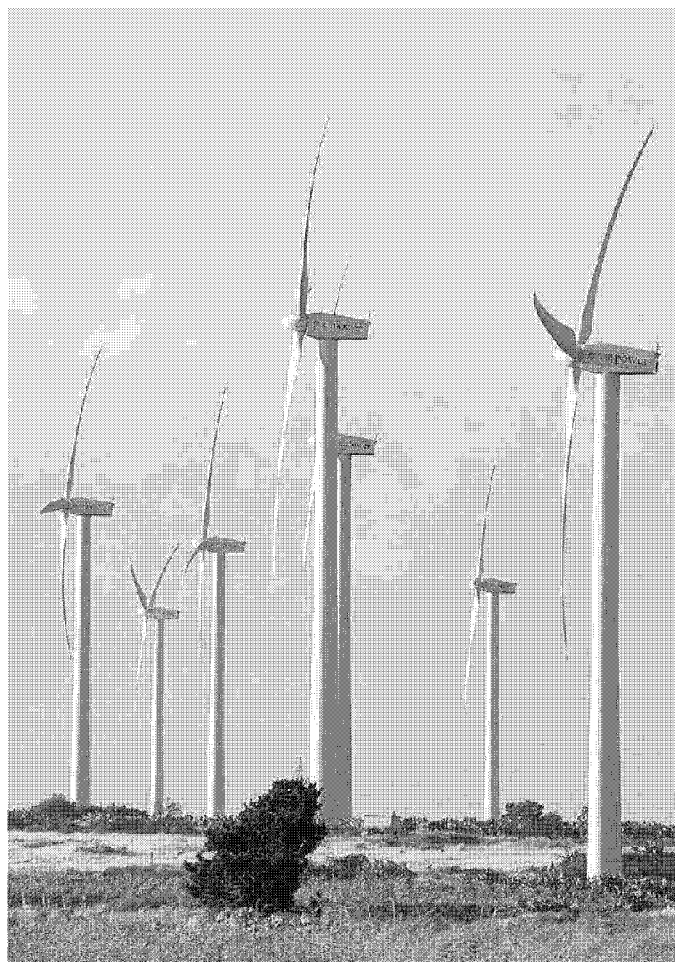
Un impianto eolico sul tipo di quello in progetto tra Campiglia e San Vincenzo
