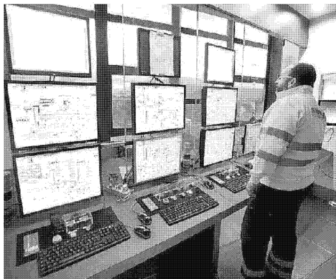
La sala controllo dell'inceneritore di Montale (foto Gori)
