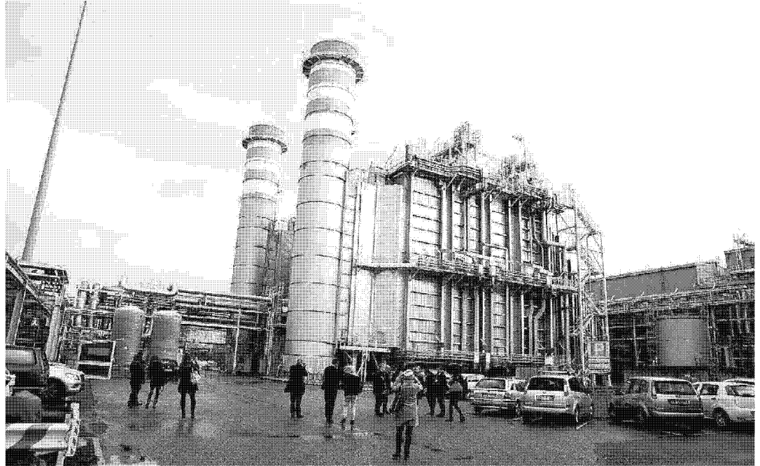
L'esterno della nuova centrale turbogas (foto Falorni/Silvi)
