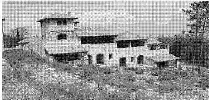
Il complesso in località Le Vigna, pronto ma in attesa di demolizione
