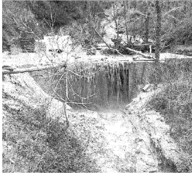
Una frana a Fabbriche di Vallico
