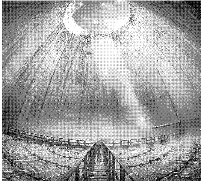
L'interno di una torre di raffreddamento di un impianto geotermico
