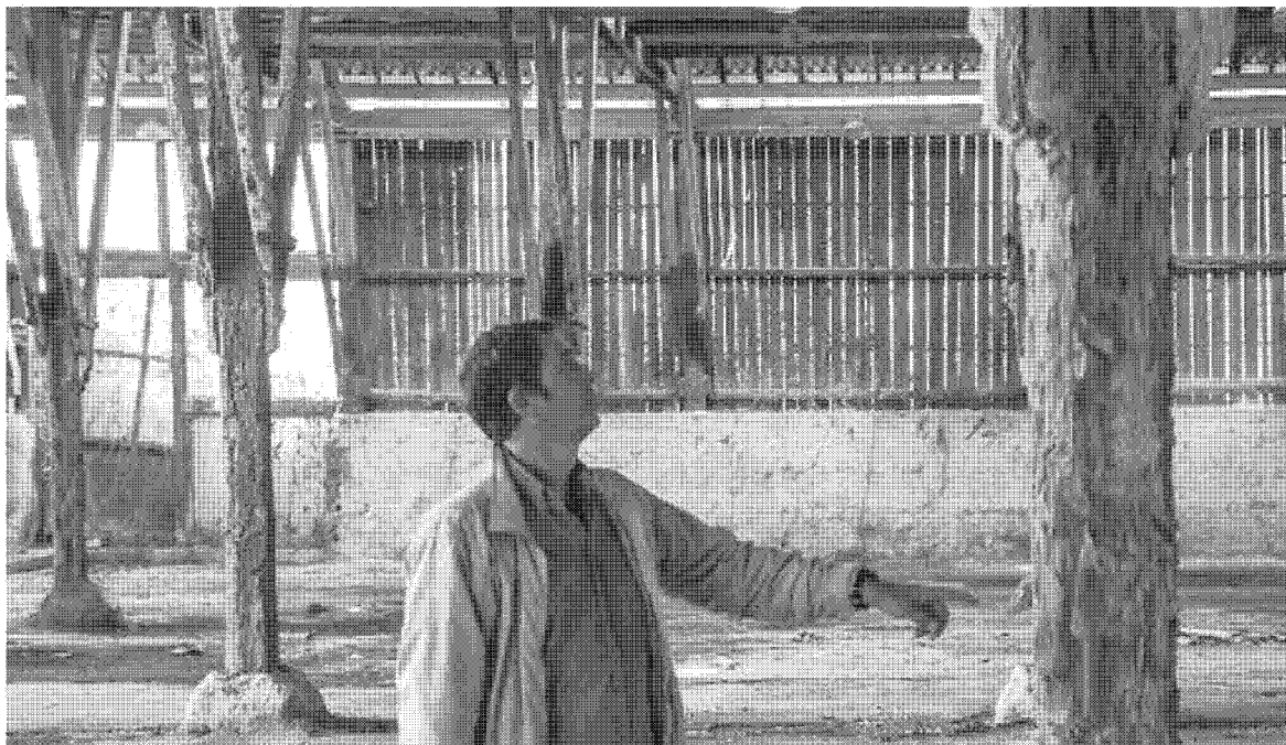
SITUAZIONE DELICATA Un'immagine delle colonne erose dagli acidi nell'ex stabilimento Sitoco
