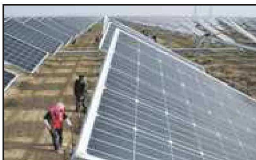
Pannelli solari a Yinchuan, in Cina
