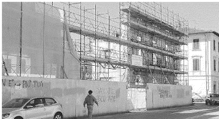
EX OFFICINE LAZZI Mancano risposte sulla bonifica dell'area inquinata che doveva essere ultimata nel 2013: rischi
