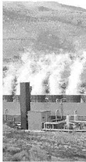
La centrale geotermica Bagnore 4
