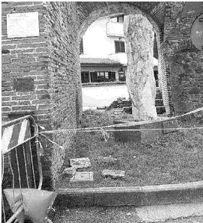
Alcune pietre cadute dalle mura
