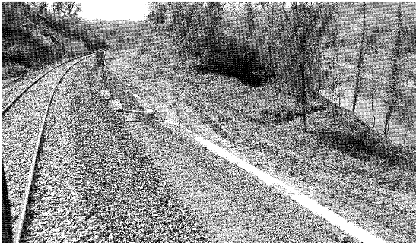
Il punto della ferrovia Grosseto-Siena franato lo scorso dicembre
