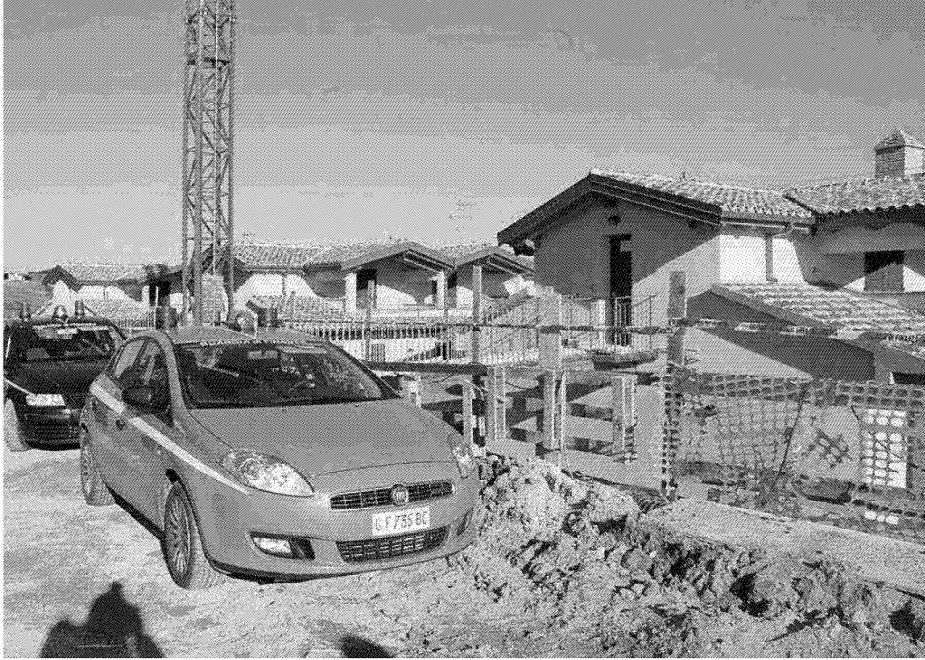
Il complesso edilizio messo sotto sequestro dalla guardia di finanza nel 2009 (foto Bf)
