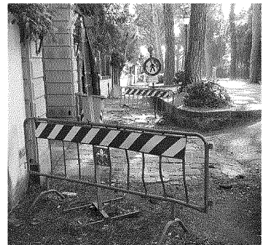
Il marciapiede di viale Torricelli in molti punti non è transitabile perché troppo scosso a causa delle radici
