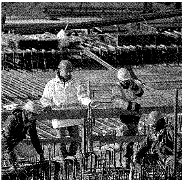
In via Circondaria i lavori per la nuova stazione alta velocità ferroviaria vanno avanti anche dopo che il progetto è cambiato
