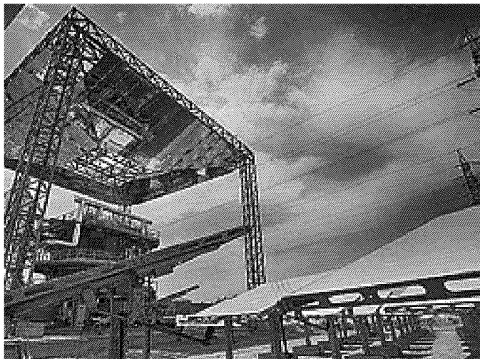
Dalla sabbia L'impianto solare termodinamico che A2A ha installato a Messina
