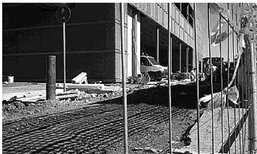
I cantieri per la costruzione del People Mover, che collegherà la stazione di Pisa all'aeroporto Galilei
