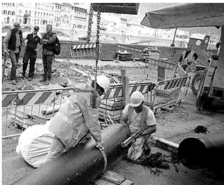
Operai al lavoro sul lungarno Torrigiani dove mercoledì mattina alle 6.15 una frana ha inghiottito le auto in sosta e spostato il muro d'argine
