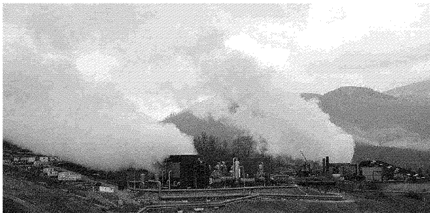
Le nubi di vapore che fuoriescono dalle torri di raffreddamento di Bagnore 4 (in primo piano) e Bagnore 3
