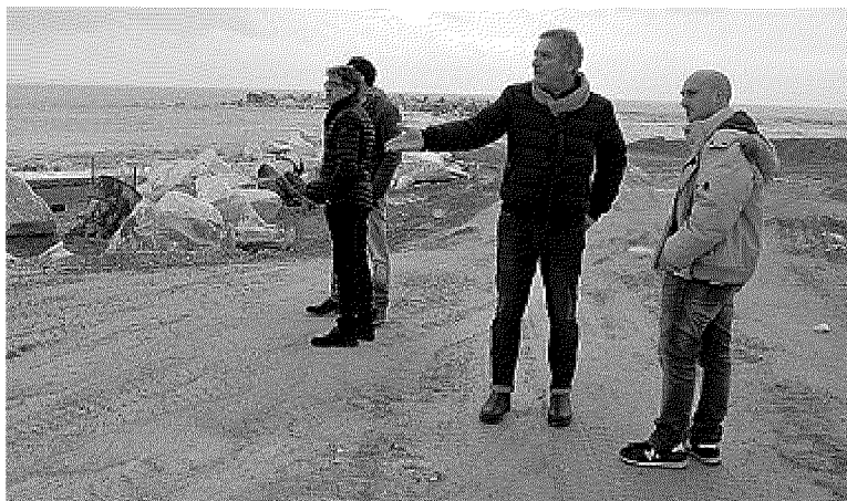
LAVORI IN CORSO Uno dei tratti del litorale marinello dove si stanno realizzando le scogliere anti erosione
