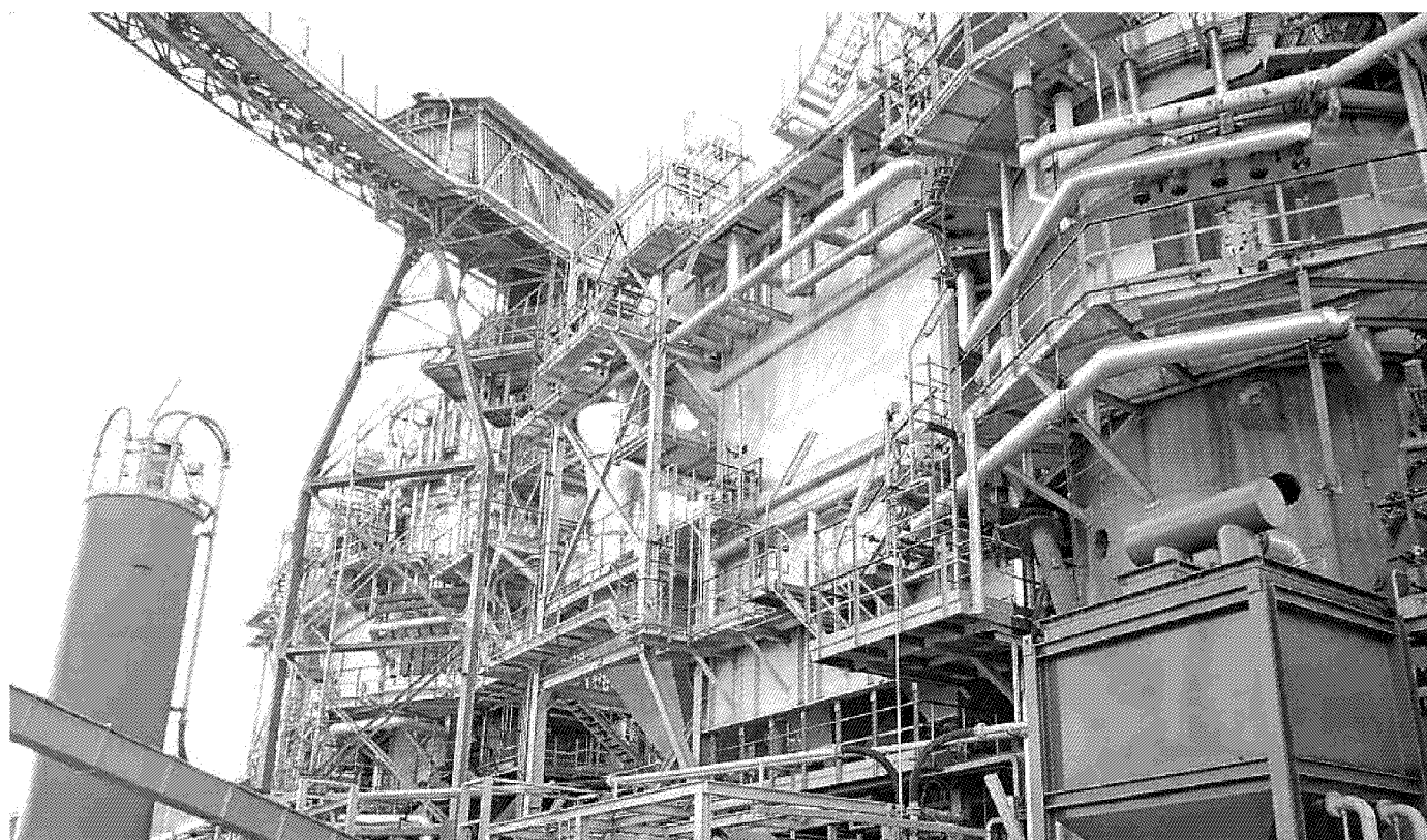
Alcuni degli impianti dell'inceneritore di Scarlino fatto chiudere dalla sentenza del Consiglio di Stato
