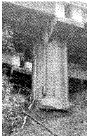
SMOTTAMENTO SOTTO L'A26 Frana sotto uno dei piloni dell'autostrada dei trafori
