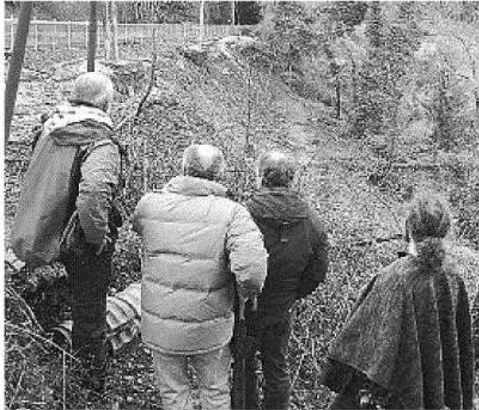
FRANA Da mesi la ferrovia Porrettana è chiusa a seguito di uno smottamento (foto Castellani)
